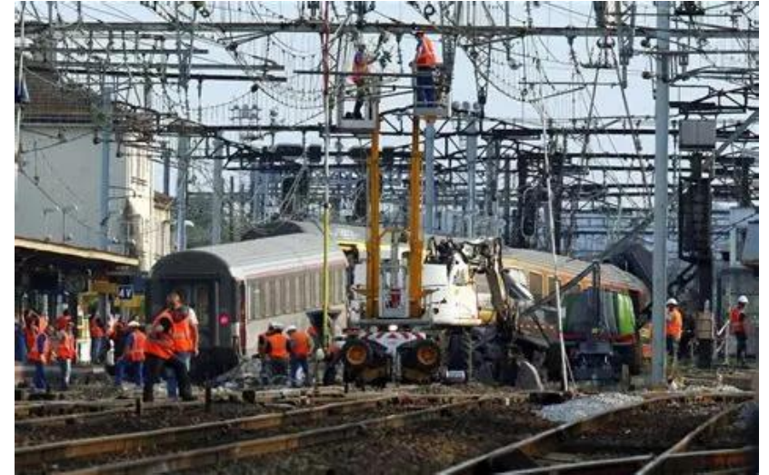
Accident impliquant un défaut d'éclisse
